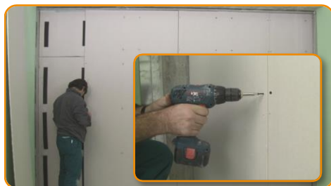
Fissare la seconda lastra di cartongesso al centro e ai lati con le apposite viti, sfalsando le lastre rispetto a quelle sotto
